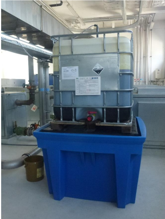
Figure 5 Cuve de stockage du chlorure ferrique
