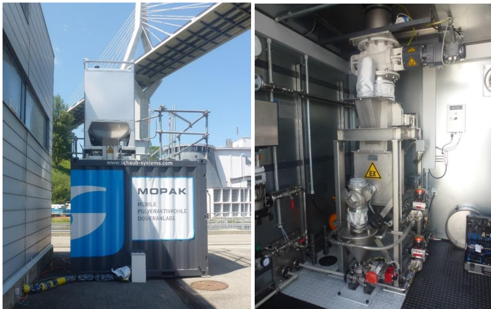
Figure 4 Installation de dosage du CAP MOPAK
