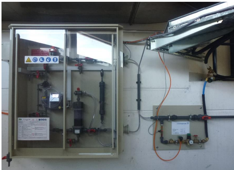
Figure 6 Armoire de dosage et poste de dilution pour le chlorure ferrique
