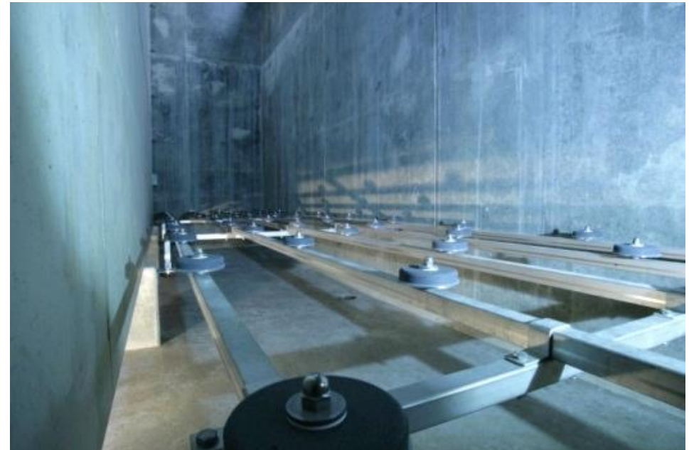
Ozon-Eintragsrampen mit Keramikk diffusoren, Quelle: ARA Neugut
