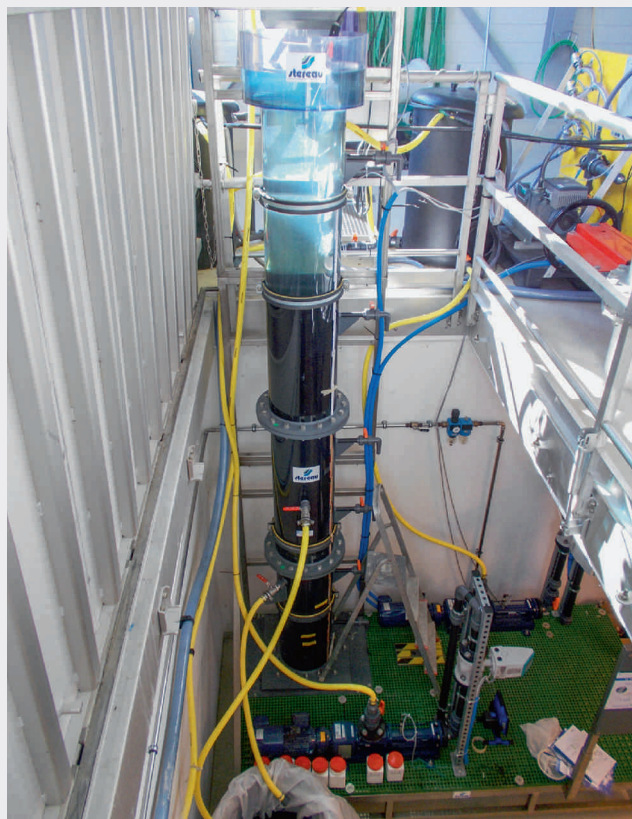
Fig. 3 Installation pilote à la STEP de Penthaz
