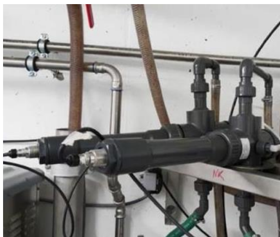
Figure 11: Sonde UV avec chambre de passage [14]
